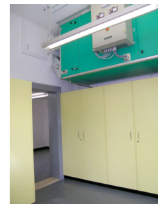
Lüftungsanlage im Nebenraum
