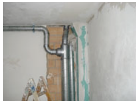
Rohre für die neue Lüftung
